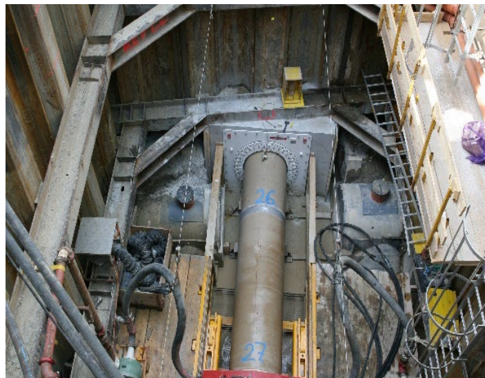
Alimentation Genève Lignes 15kV CFF
